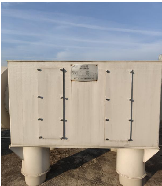
活性炭过滤箱（有机废气净化器）
