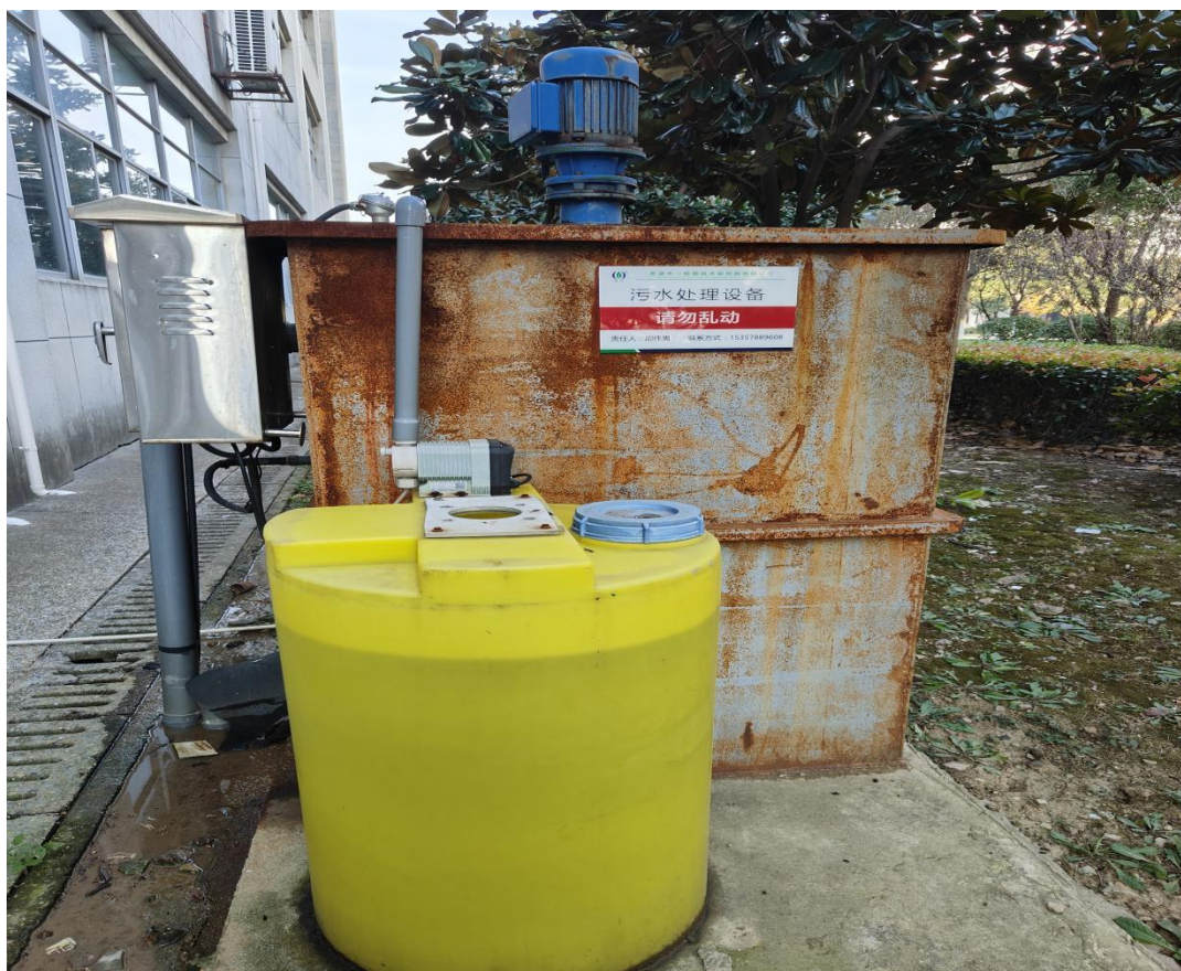
一体化水处理设施
